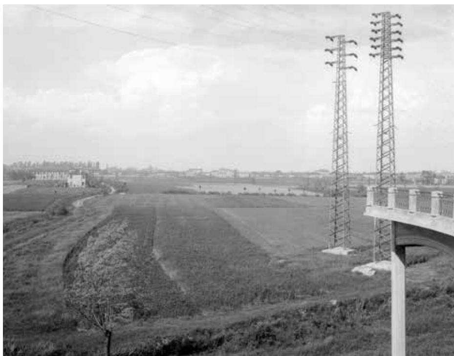
Il cavalcavia in costruzione termina sul vuoto verso Mestre, allora aperta campagna, dove si svilupperà corso Umberto Primo (ora Corso del Popolo), attorno al 1930 (foto Comune di Venezia, Biblioteca Civica VEZ, Fondo Archivio Fotografico Giacomelli).
